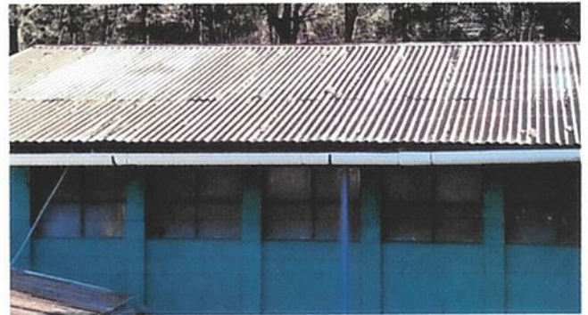
Foto 2: Techo de aula No. 1 y 2, y corredor deteriorado.
