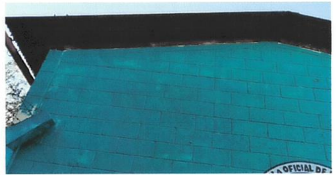
Foto 4: La estructura de soporte de metal necesita mantenimiento.
