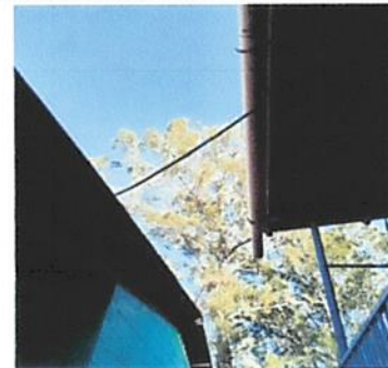
Foto 6: Las bajadas de agua necesitan reparación.
