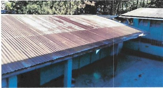
Foto 1: Techo de Aula No. 4 y corredor deteriorado.
